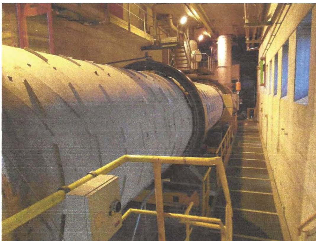
Figura 7 - 5: Tehnologia cilindrilor rotativi pentru piroliză și ardere ulterioară (ERZO gestionarea deșeurilor regiunea Zofingen, CH-4665 Oftringen
